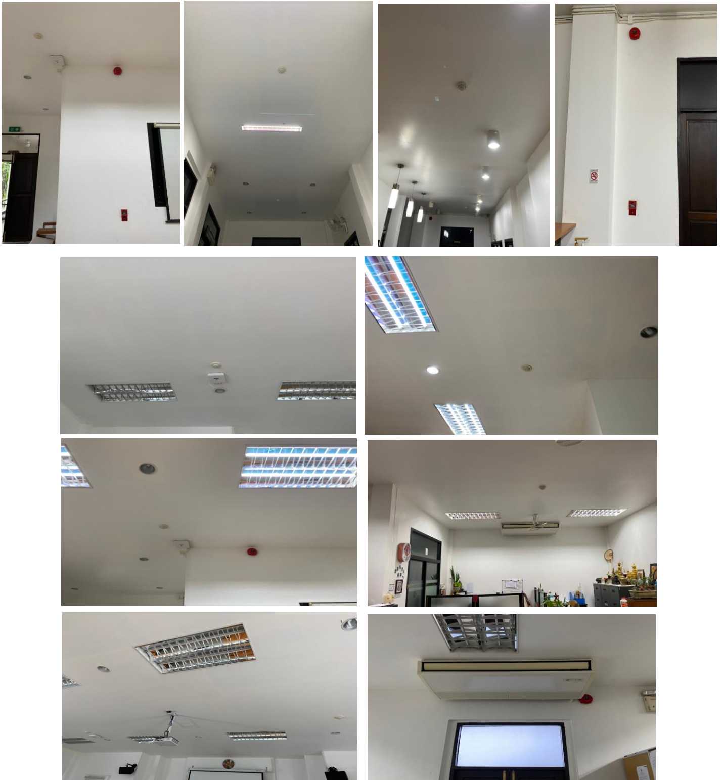
ภาพตัวอย่างการติดตั้งสัญญาณแจ้งเหตุเพลิงไหม้ และตัวดักจับควัน (Smoke Detector) ของสำนักส่งเสริมศิลปวัฒนธรรม มหาวิทยาลัยเชียงใหม่
